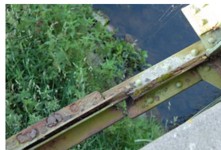
Deutlich sind die Beschädigungen und Durchrostungen sichtbar
